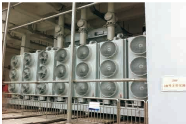
三峡工程28号机组主变压器—武钢取向电工钢
